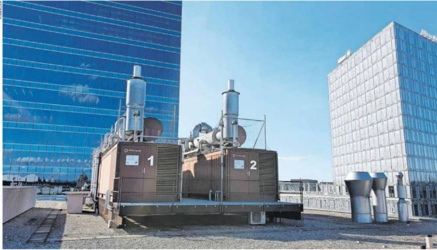
2 x 1 MW el sur un toit à ZH (ici une génératrice de secours, photo Powerloop.ch )
