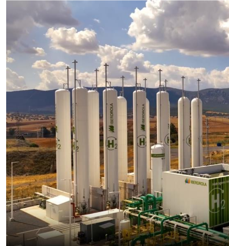
Les réservoirs Iberdrola Env. 20 MWh de H 2 par réservoir
